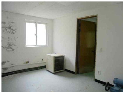
<전기실 내부 전경>
