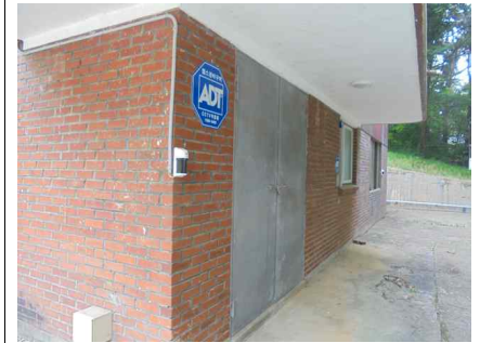
<전기실 외부 전경>
