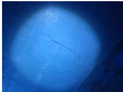
<1지 상부슬래브 철근노출>
