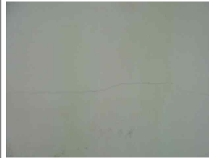
<전기실 벽체 균열>
