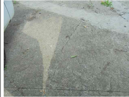
<콘크리트 포장 균열>
