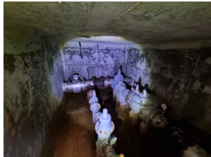
<유출유량계실 내부 전경>
