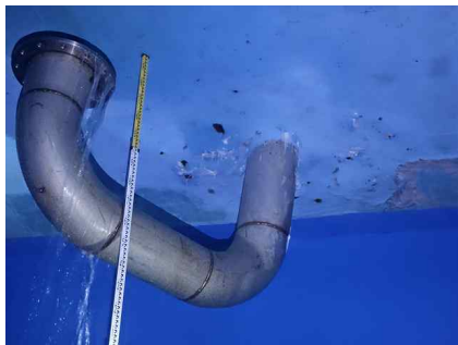
<1지 상부슬래브 백태>
