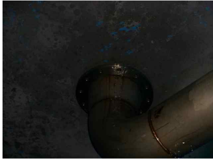
<기계설비 2지 배수지 차수불량>
