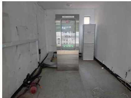
<전기설비 현장제어반 상태양호>
