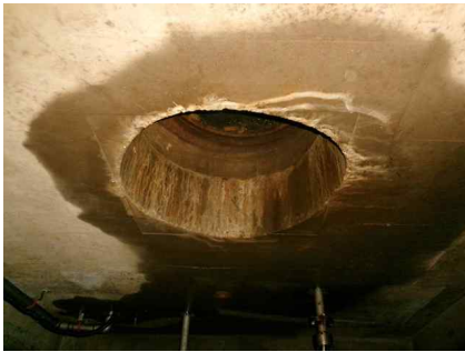
<유입밸브실 상부슬래브 백태>
