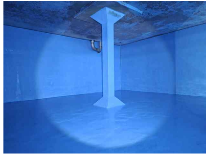
<배수지 2지 전경>
